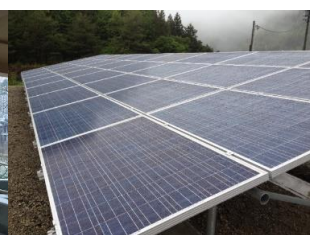
太陽光パネル
