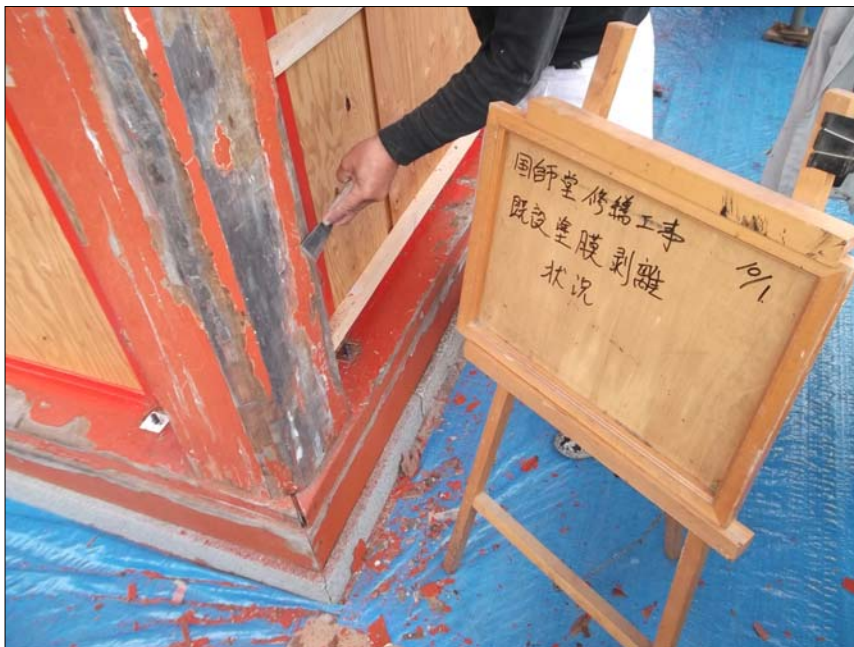
既設塗膜剥離状況
